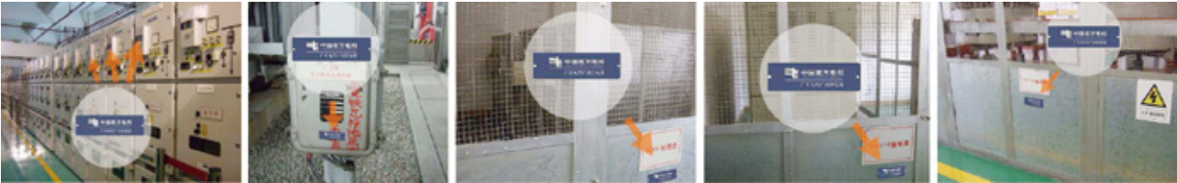
开关柜、主变室、电抗器、站用变、接地变
