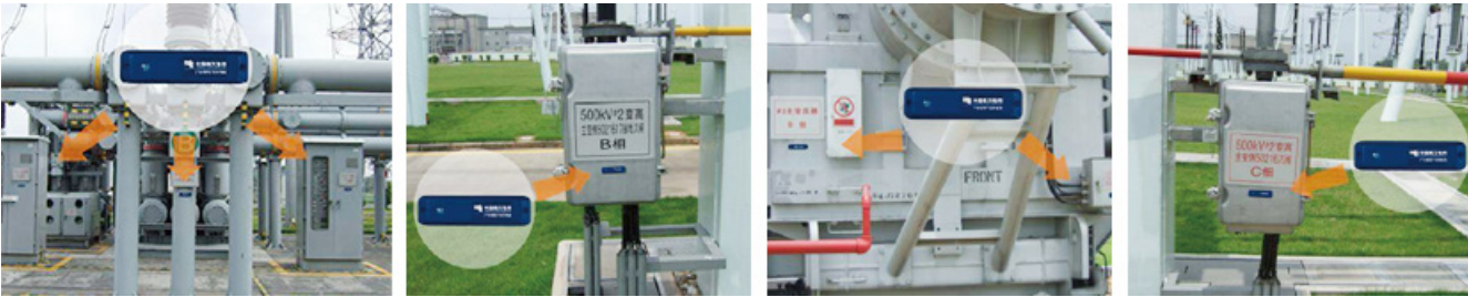
开关汇控柜、主变侧接地刀闸、主变压器、主变侧刀闸
